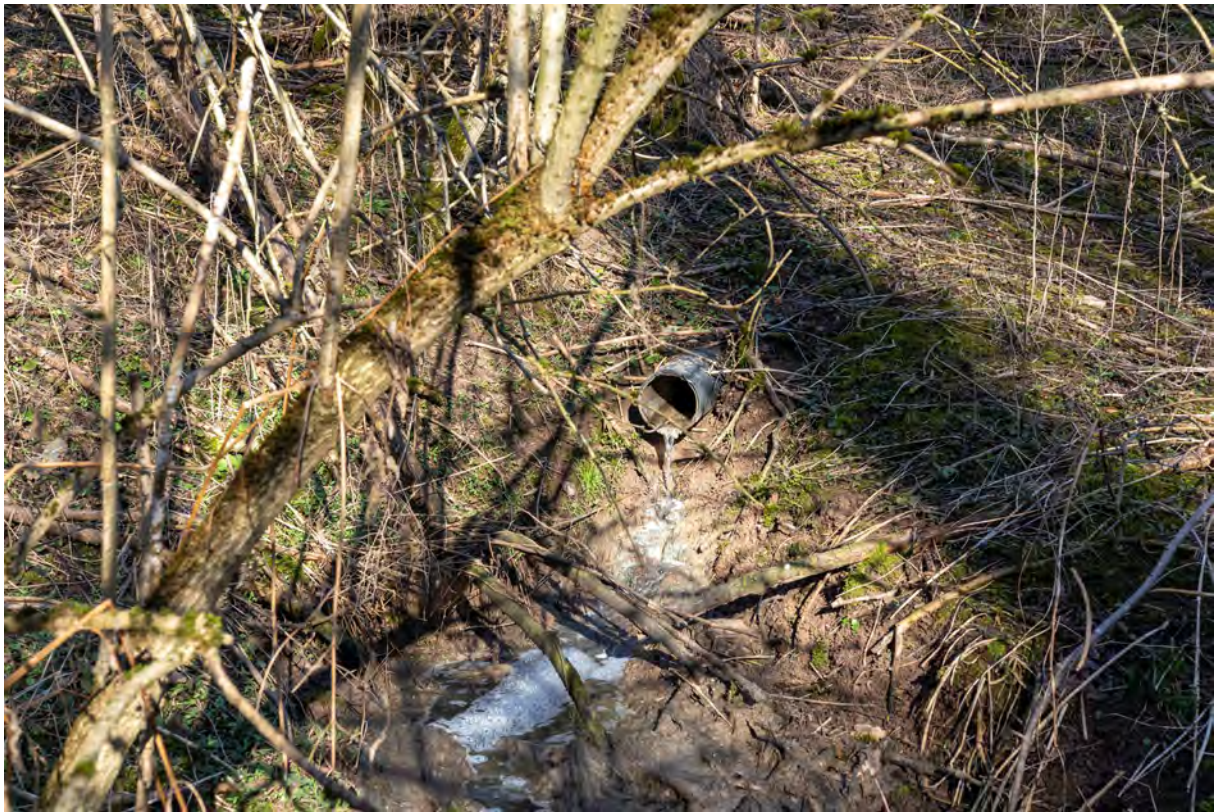
Abb.: Illegale Abwassereinleitung in die Giebelrainquelle 10
