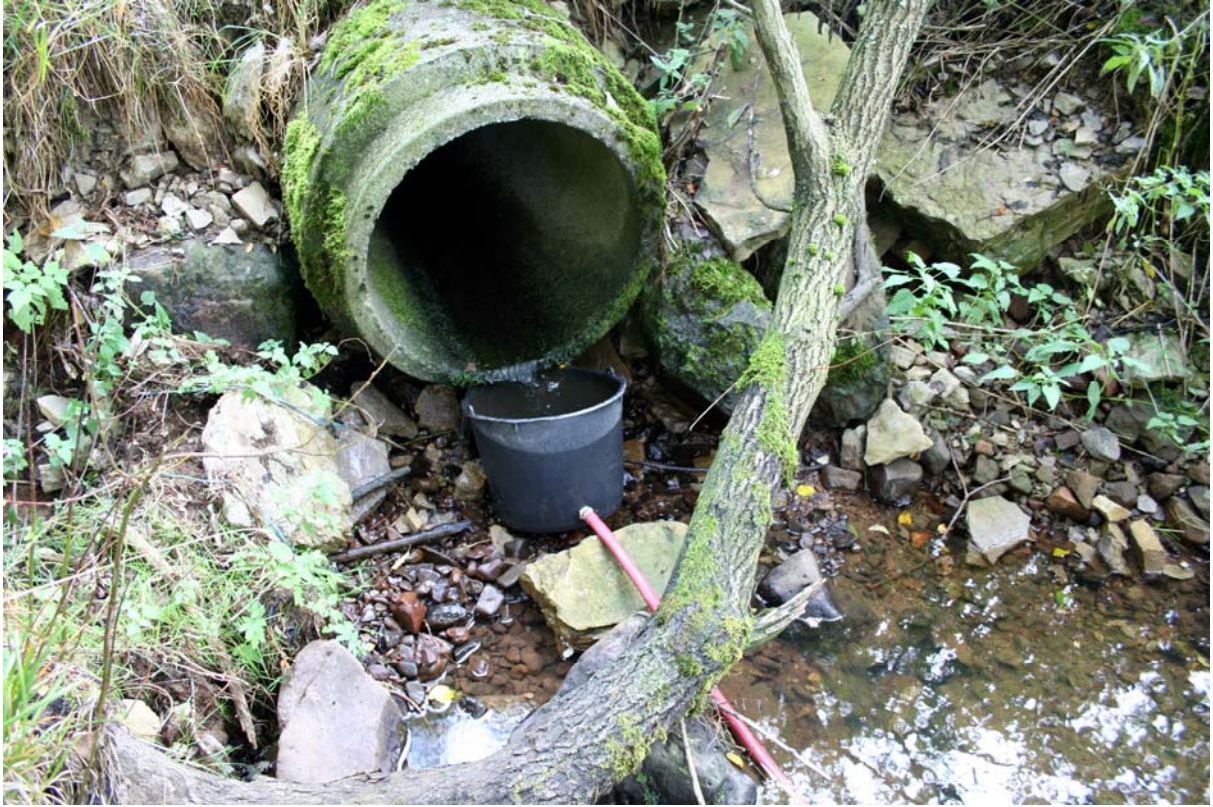
Abb: Verrohrung und Wasserentnahme am Querenberg
