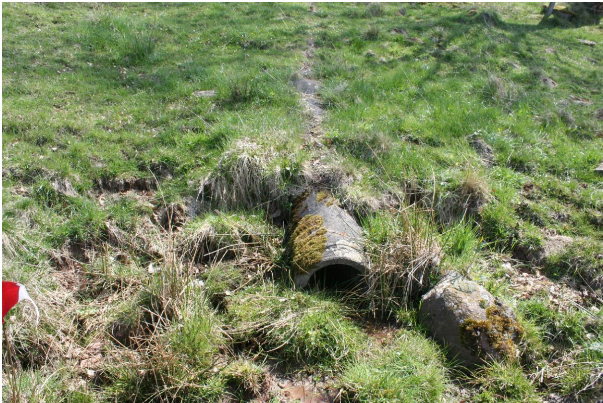
Abb.: Verrohrung im Bereich der Thaidener Hutequelle 41
