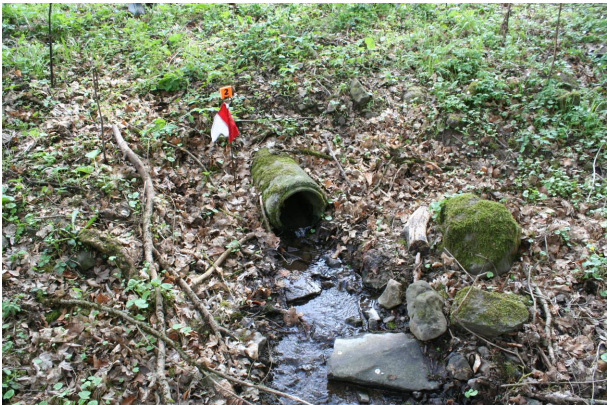
Abb.: Verrohrung an der Buchschilderquelle 36
