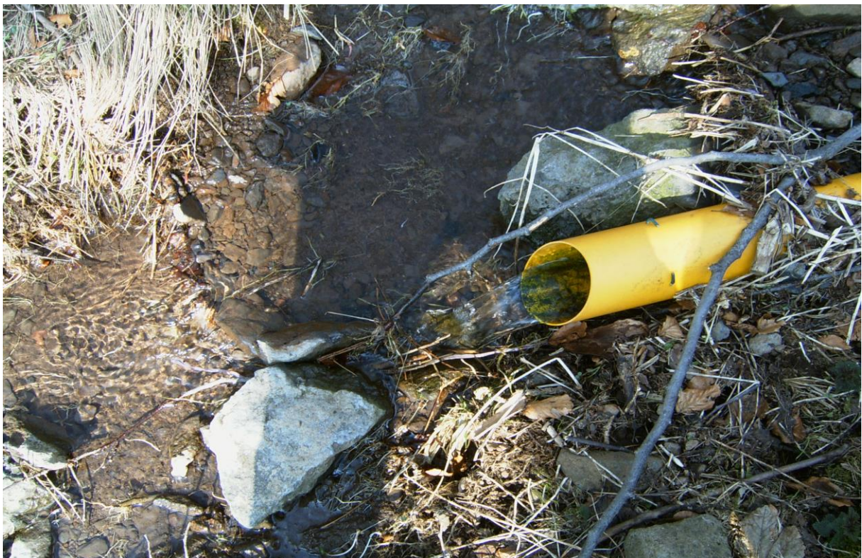
Abb.: Drainagerohr in der Steinkopf Hutequelle 12
