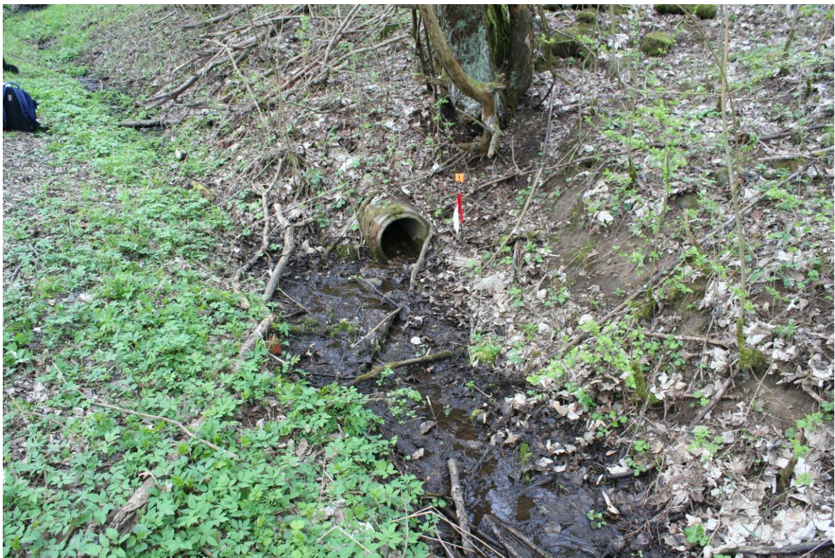
Abb.: Verrohrung an der Buchschirmquelle 105
