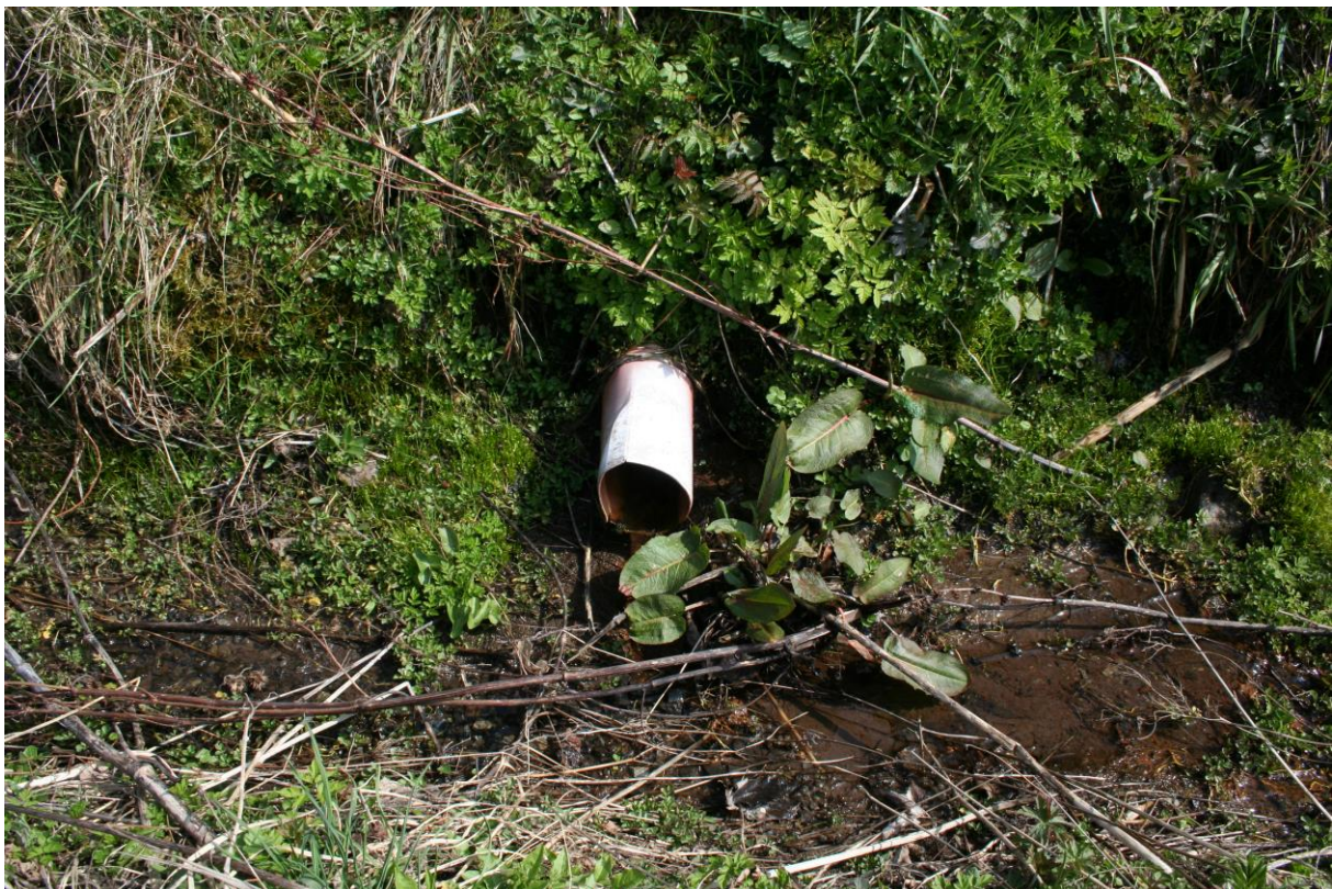
Abb.: Drainagerohr in der Herrenwasserquelle 6
